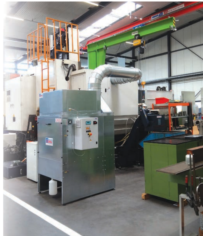
▲ OIL STOP 6 • con quadro elettrico (OPTIONAL) e plenum insonorizzato (OPTIONAL) • avec armoire électrique (OPTIONAL) et plenum insonorisé (OPTIONAL) • with control panel (OPTIONAL) and soundproofed (OPTIONAL) • con armario eléctrico (OPCIONAL) y plenum insonorizado (OPCIONAL) • mit Schaltschrank (optional) und Schalldämmhaube (optional)
